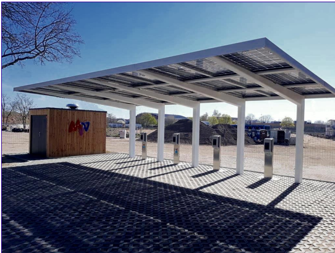
Abbildung 47: PV-Carport von Clickcon mit 10 kWp Solarleistung (Quelle: eigenes Bild).
